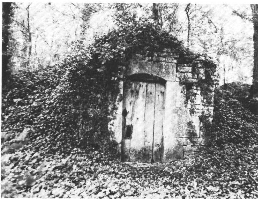
La porte en chêne de la grande glacière et son encadrement en pierre de taille.
